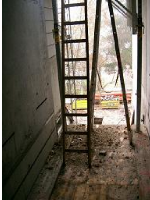
Fehlende Absturzsicherung und ungesicherte Leiter
